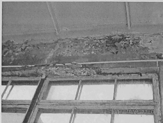
Фото повреждённого участка стены в месте протечки кровли.
